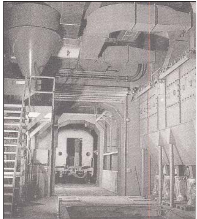
▲ Particolare dell'impianto di sverniciatura.
