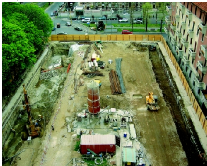
Il cantiere del parcheggio pertinenziale di piazza Dateo, a Milano, iniziato nella primavera 2003
