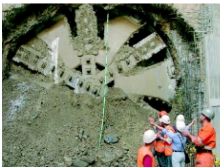
Caduta di uno degli ultimi diaframmi della galleria della metropolitana di Torino
