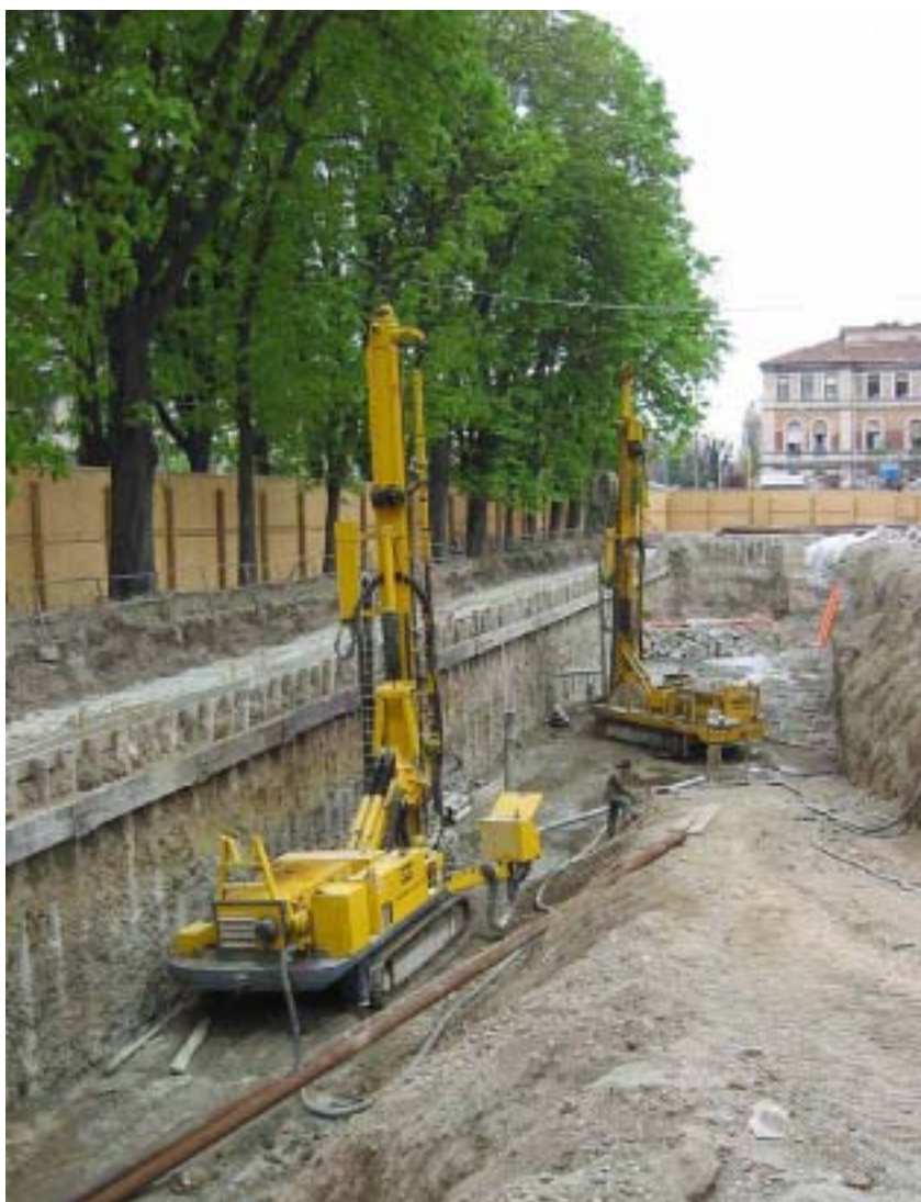
Particolare del cantiere del parcheggio per residenti in piazzale Dateo a Milano.
