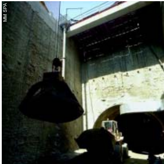
Particolare del cantiere della stazione Dergano della linea 3 della metropolitana di Milano
