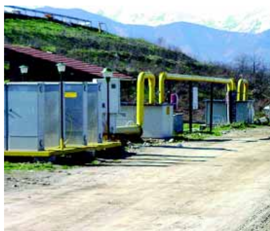
Centrale elettrica della stazione di biogas della discarica di Torino
