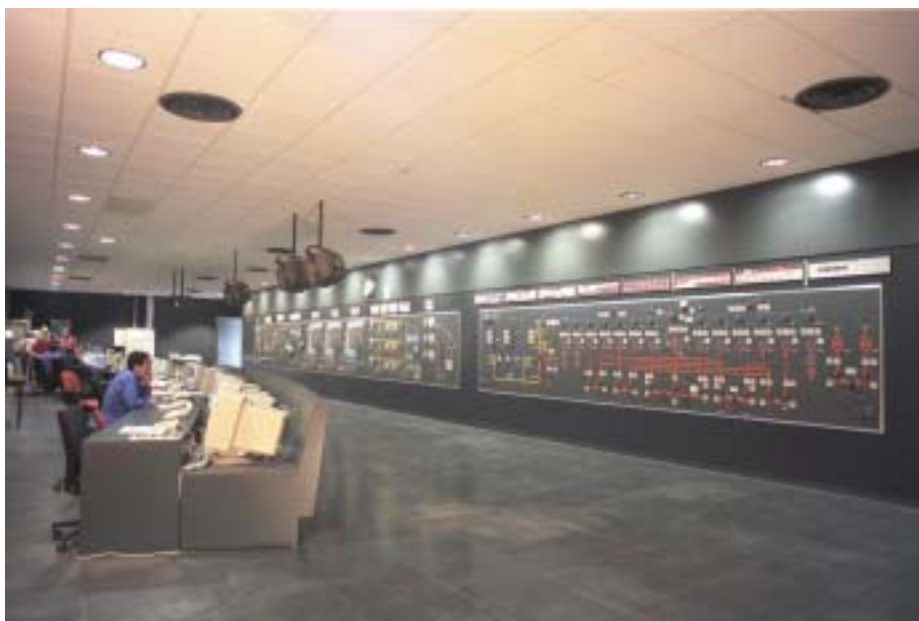
Sala controllo di Silla2
