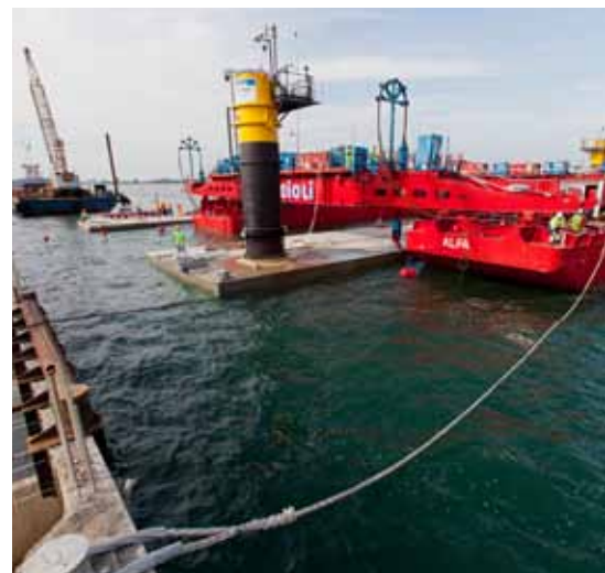
Traino e varo di uno dei primi cassoni di alloggiamento del sistema Mose della barriera di Lido nord
