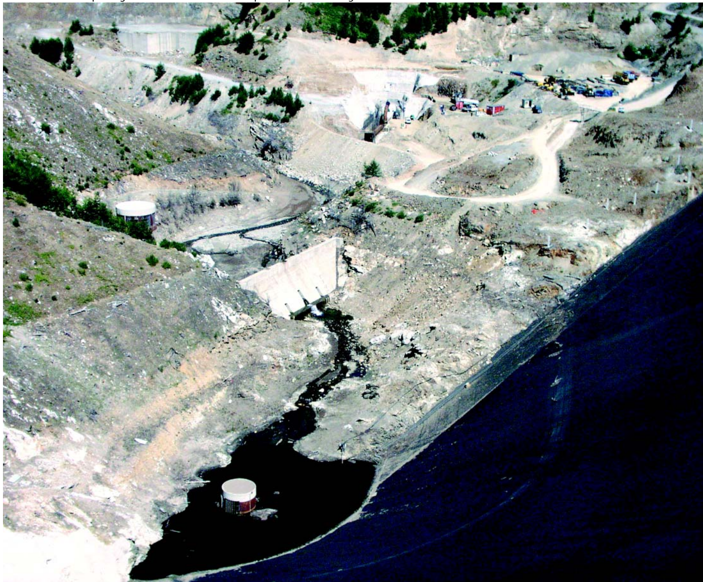
Veduta del cantiere per la galleria di derivazione e dell'opera di presa della diga
