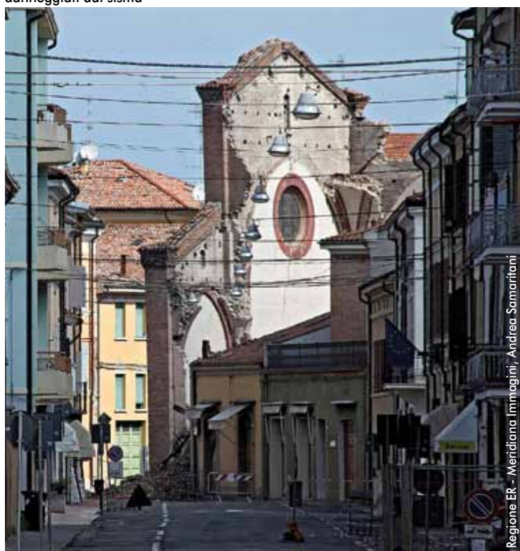
Chiesa di San Francesco ed edifici del centro storico di Mirandola (MO) danneggiati dal sisma
