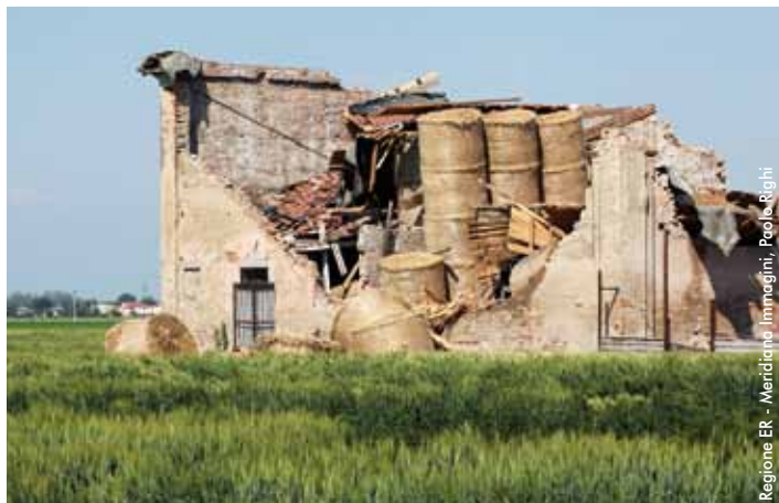
Edifici agricoli lesionati dal terremoto in Emilia, a Camurana, frazione di Medolla (MO), Maggio 2012
