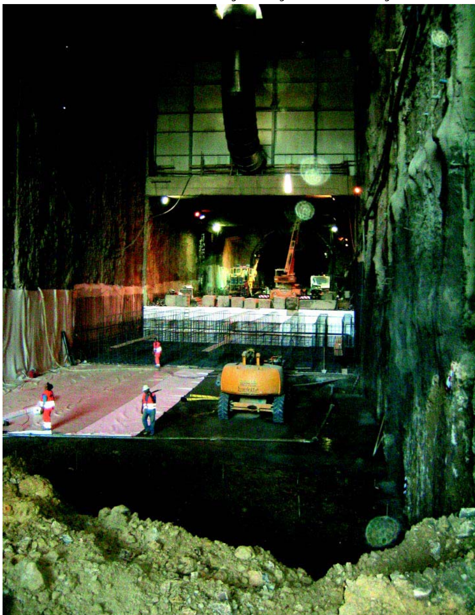
Innesto fra il tratto in naturale e in artificiale della galleria Vaglia della linea AV Bologna-Firenze
