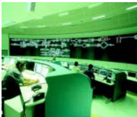
Il Posto centrale di Pisa del Sistema di comando e controllo (Sc) della circolazione ferroviaria
