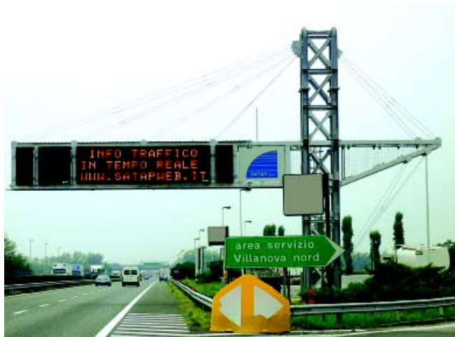
Particolare dei pannelli a messaggio variabile sulla A21
