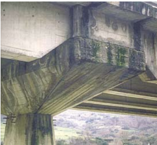
Particolare del pulvino di un viadotto della Statale del Biferno prima dell'intervento di ricostruzione
