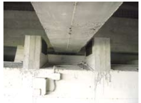
Ritegni di fine corsa per un viadotto in zona di frana, con blocchi in calcestruzzo e cuscinetti di neoprene
