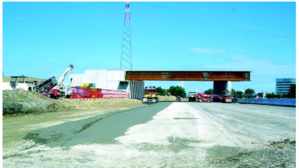
Il cantiere dei nuovi svincoli sulla A8, con la prima campata del ponte e una delle nuove carreggiate laterali
